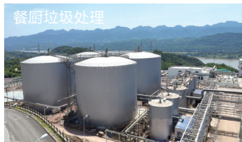
餐厨垃圾处理 重庆洛碛餐厨垃圾污泥协同厌氧项目 餐厨垃圾2100吨/天 市政污泥400吨/天
